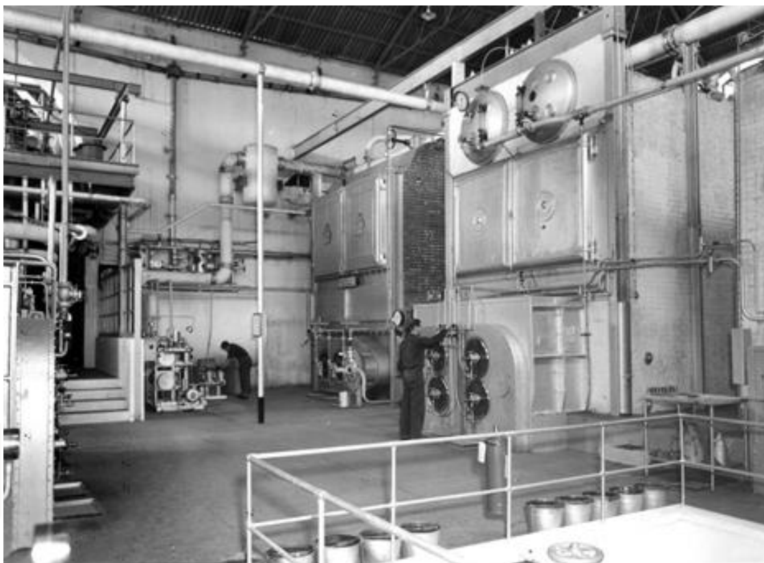
Figura 16 – Sala das Geradoras de vapor “Babcock & Wilcox”.
