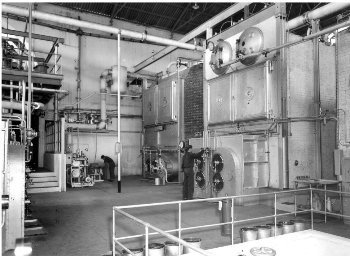
Figura 88 – Sala das geradoras de vapor “Babcock & Wilcox”, utilizando fuel oil como combustível. Fonte: Espólio da SINAGA a/c do Museu Carlos Machado.
